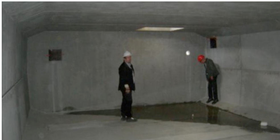
Rambølls 150 m 3 regnvandstank
